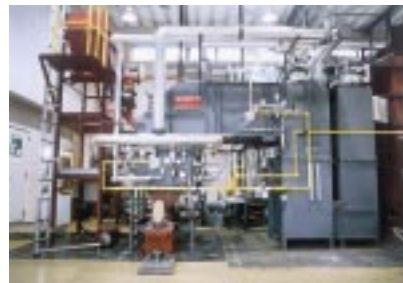
小規模型 RDF 無公害 燃焼システム
