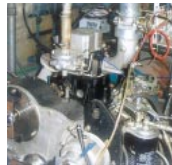
天然ガスエンジン外観
