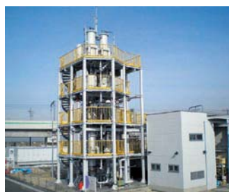
あいち臨空新エネルギー研究発電所
