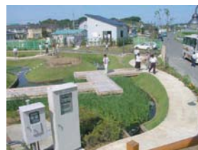
電気化学的高速廃水処理装置を設置した生活排水路浄化施設
