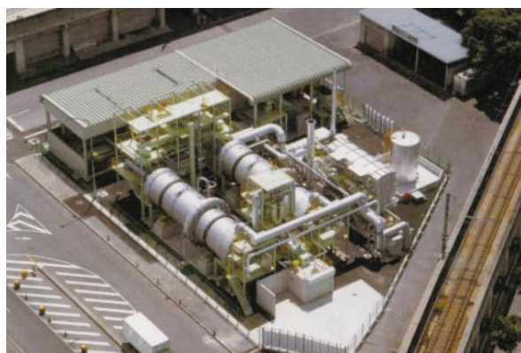
生ごみ処理プラント
