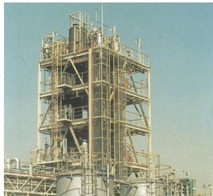
廃液処理プラント
