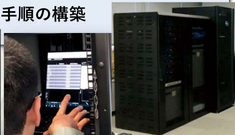
千葉県庁に設置の津波遡上即時予測システム
