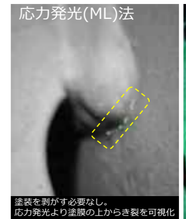
塗装を剥がす必要なし。応力発光より塗膜の上からき裂を可視化
