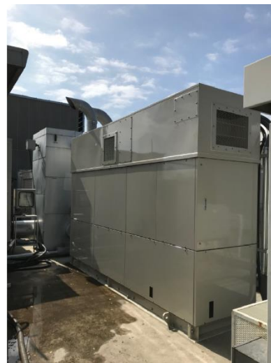
図 11 新 50kW アンモニア燃焼 MGT 設置状況
