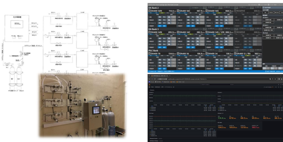
図 8 高圧放電スイッチのガス圧遠隔制御システム
