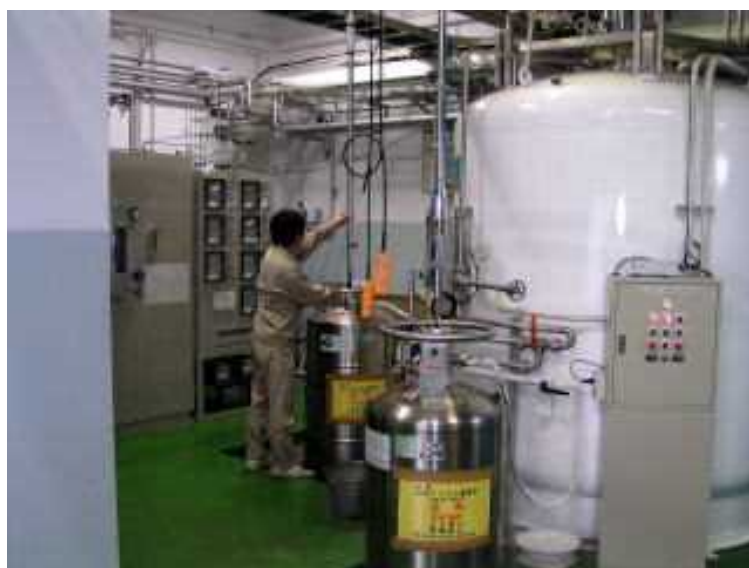
図6 液体ヘリウム供給設備と、供給容器への液体ヘリウムのくみ出し作業の様子。
