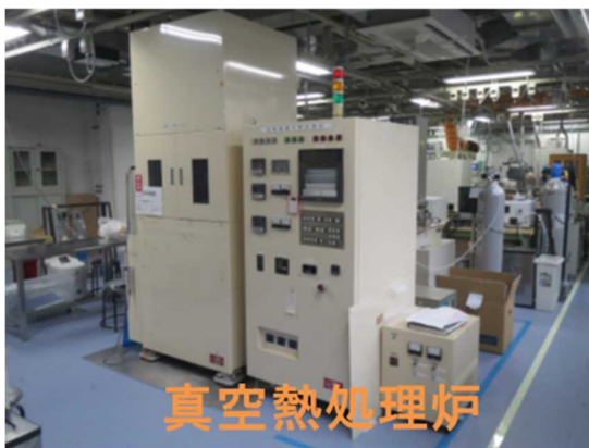
(b) 1号館共通実験室へ設置した装置群 (スパッタ装置、真空熱処理炉)
