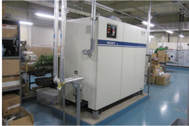
図9 一本化して効率化をはかった超純水製造装置
