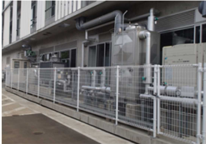
①メンテナンスした共通実験室冷却水循環システム
