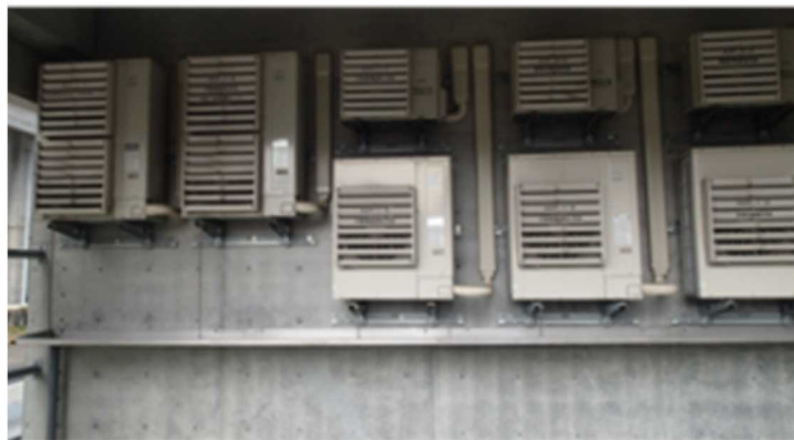
②メンテナンスした共通実験室空調システム
