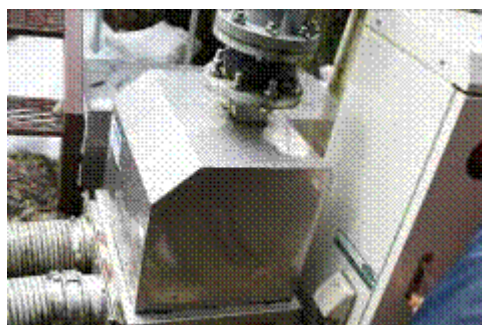
(写真) 延利の水力発電施設
