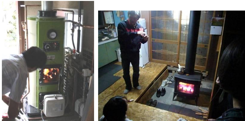
図 50 薪ボイラーと薪ストーブ
