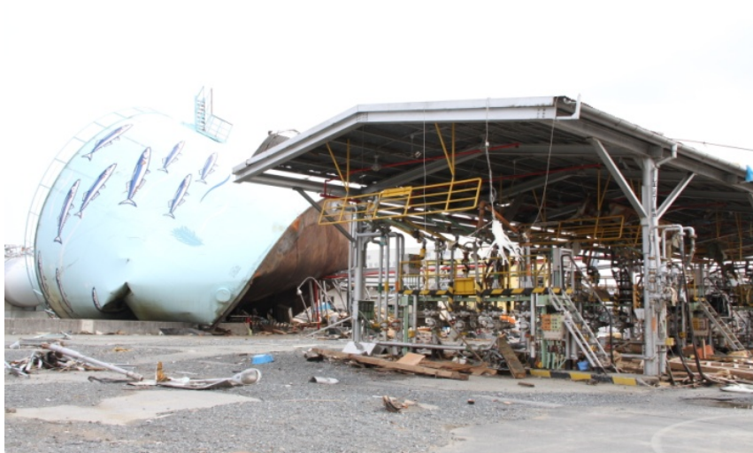
潰れた石油タンクと給油所
