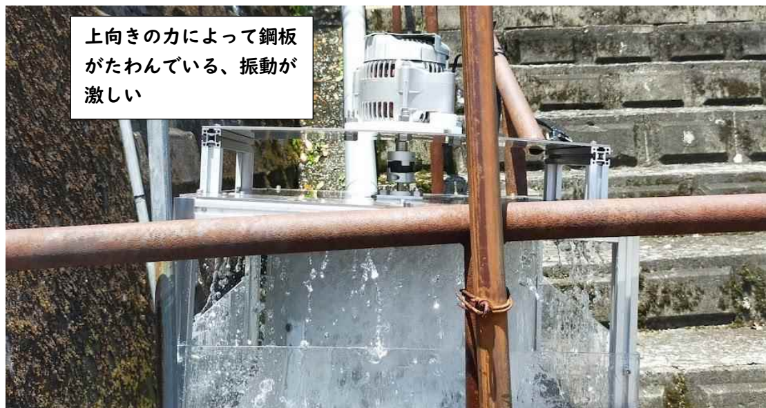
図 18 発電機を支える台が上にたわんでいる
