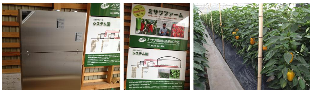
図表 2 4 - 3 三沢環境技術(株)の地下熱利用農業ハウス
