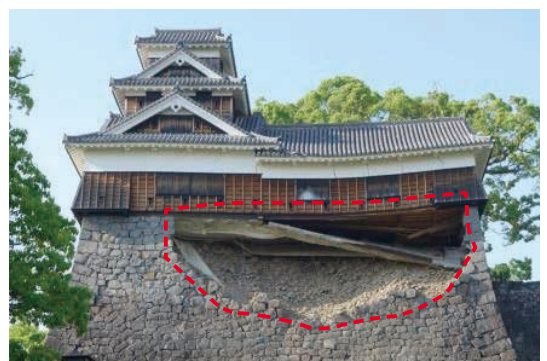
図1 崩落した飯田丸五階櫓の石垣
