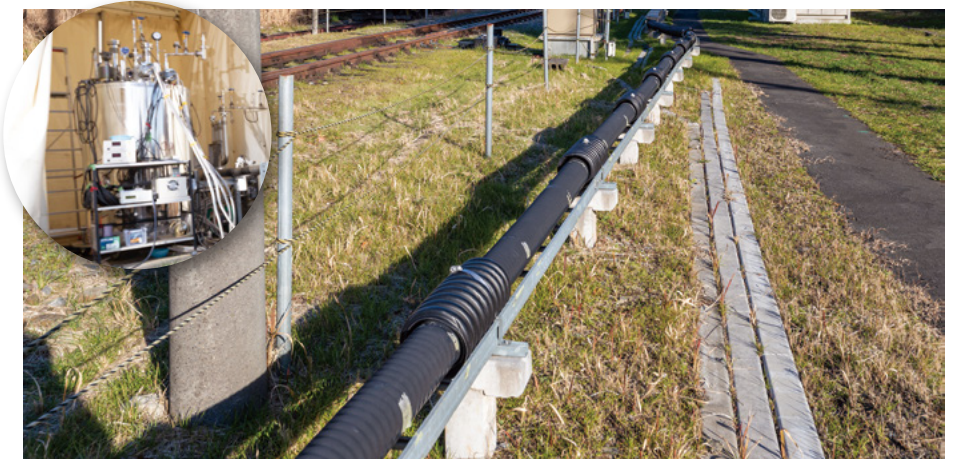
■図3 走行試験を実施した鉄道総研内の実験線。起点には冷媒機と液体窒素の循環用ポンプなどがある(囲み写真内)。
