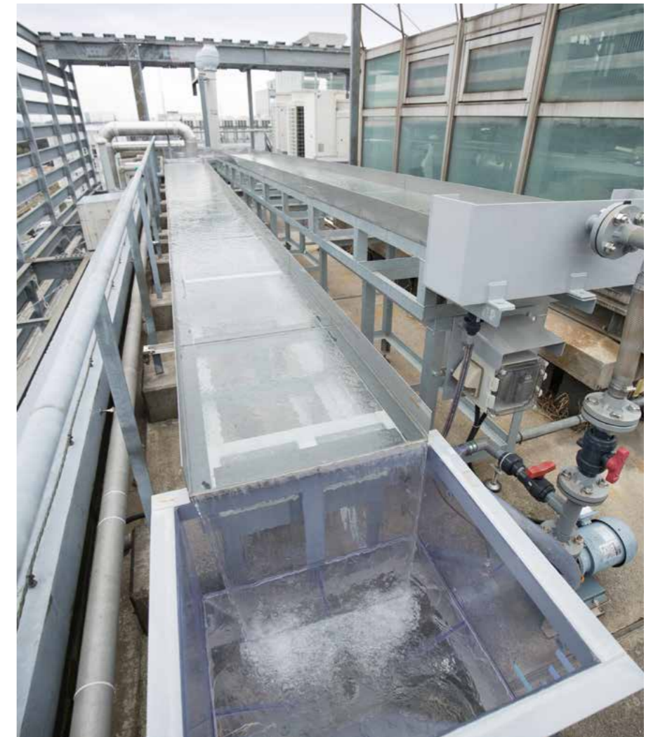
屋上に設置された大型培養槽。取材時は冬季であったため屋外の培養は行われておらず、流れているのは撮影用に入れた水道水。
