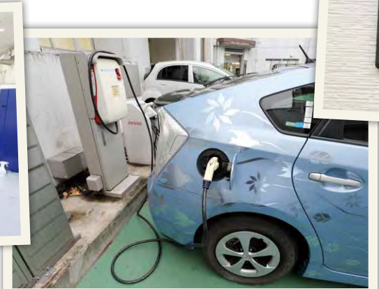
電気自動車やプラグインハイブリッド車に充電する設備もある。
