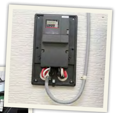
スマートメーター。2023年までに、全国に設置される予定。
