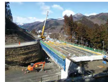
実証実験の分析結果は早くも復興現場で活用されている。その1つが、釜石道路の向定内橋（むかいさだないはし）の床版（岩手県釜石市）。期待値では更新までの期間が2倍に延びる。
