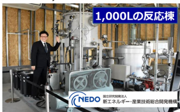
図. 北海道興部北興バイオガスプラントに建設されたバイオメタンガスからのメタノール・ギ酸の製造プラント. 第2期の装置では全てをギ酸として取り出す方法が考案された。得られたギ酸は、水素ガス製造の原料とするほか、牧草を乳酸発酵させる薬剤として使用される予定である。
