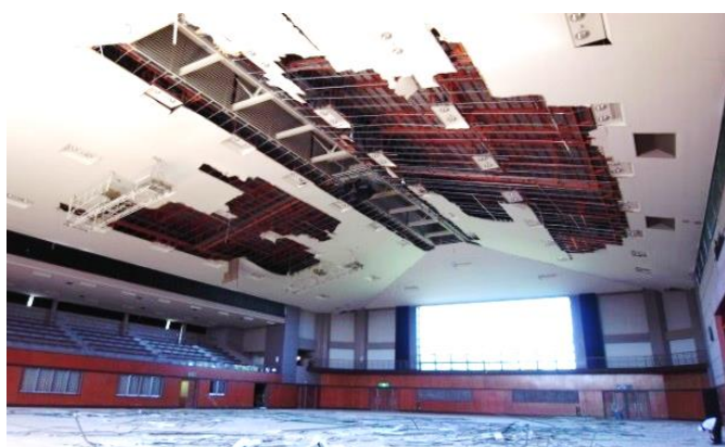
東北地方太平洋沖地震 講堂天井落下事例
