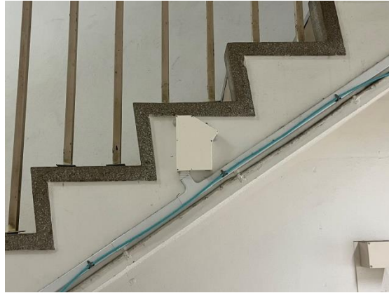
図 5.5.2 センサユニット設置状況
