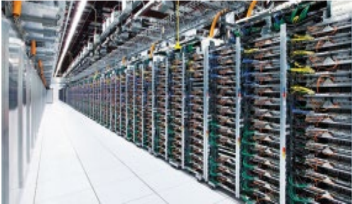
データセンター内部
