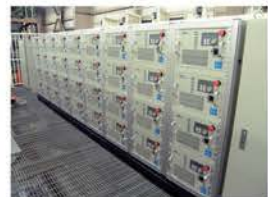
PVパネル模擬電源装置
