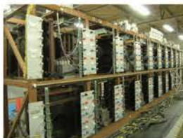
275kV送電線模擬装置
