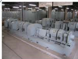
同期発電機模擬装置
