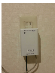
電力測定装置
