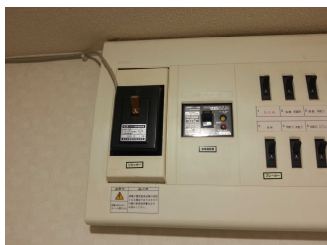
家庭内配電盤からの電力の測定
