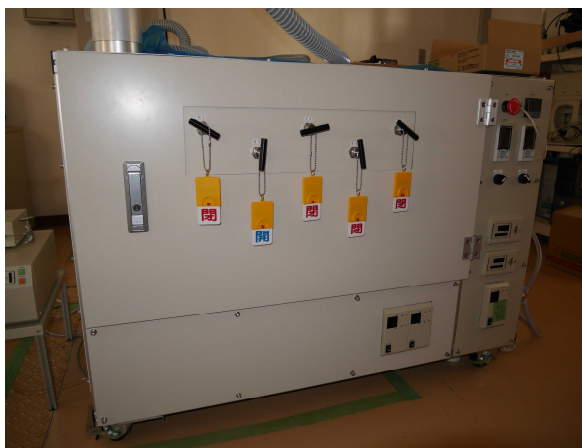
図 2. 高圧水素発生装置
