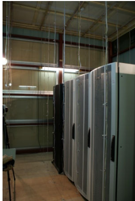
図2 実験用モジュール内部(ラック前面側)
