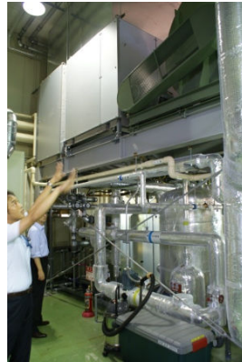
図3 外気条件再現用の空調設備
