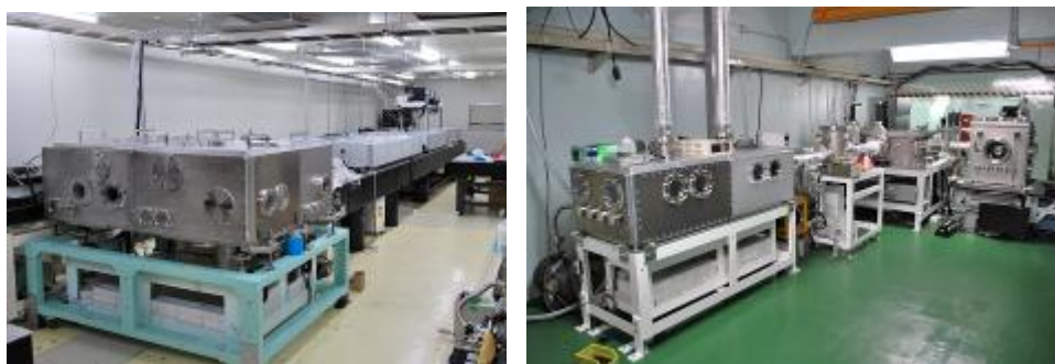
図1 アップグレード中のレーザー装置と、ユーティリティー整備中の実験エリア
