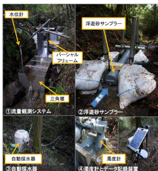
図4 水土砂流出観測システム
