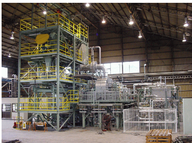
写真1 MEET-II灰溶融ガス化実証プラント
