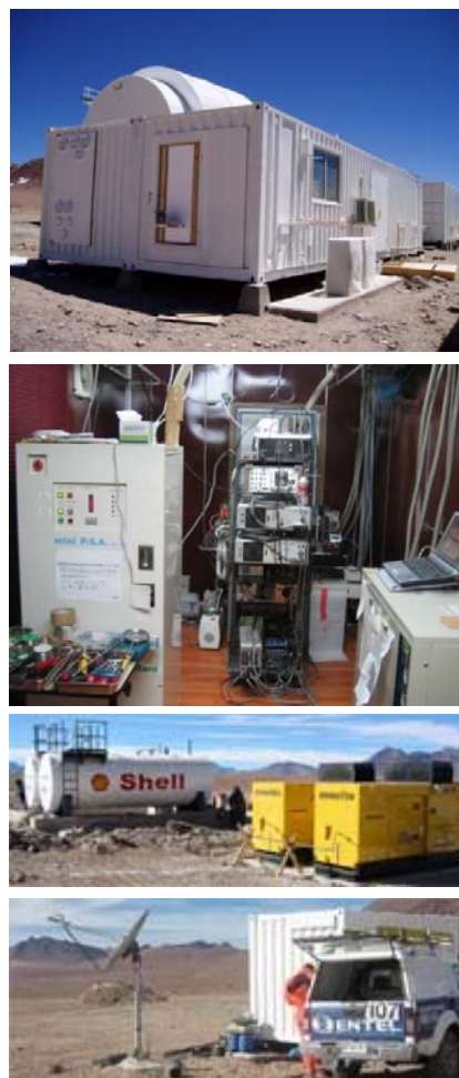
図 21. 上からアタカマ高地の大気観測棟、観測棟内、発電施設、通信施設の
