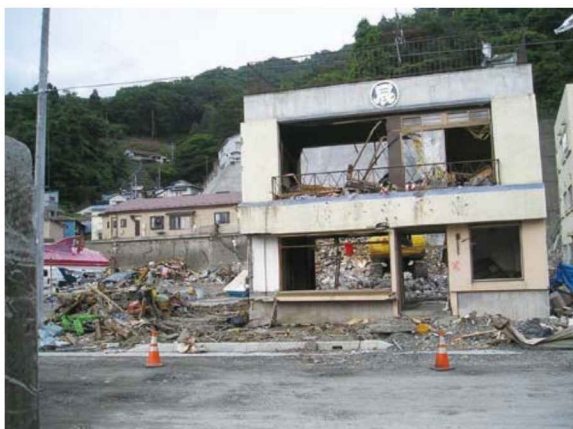
大津波後の丸辰カマスイ本社
