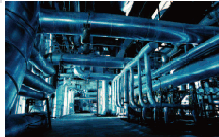
発電プラント Power Plant
