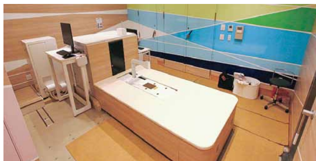
【写真1】京都大学附属病院に設置したワイドフィールド可視化システム
