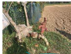
ヒ素を含む地下水(灌漑水) を汲み上げるポンプ
