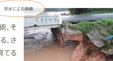
洪水による損傷
