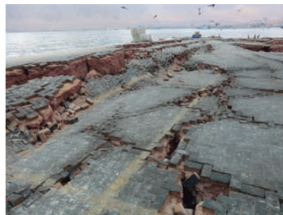
地震動により被害を受けたイキケ港の埠頭。余震によっても被害が拡大。
