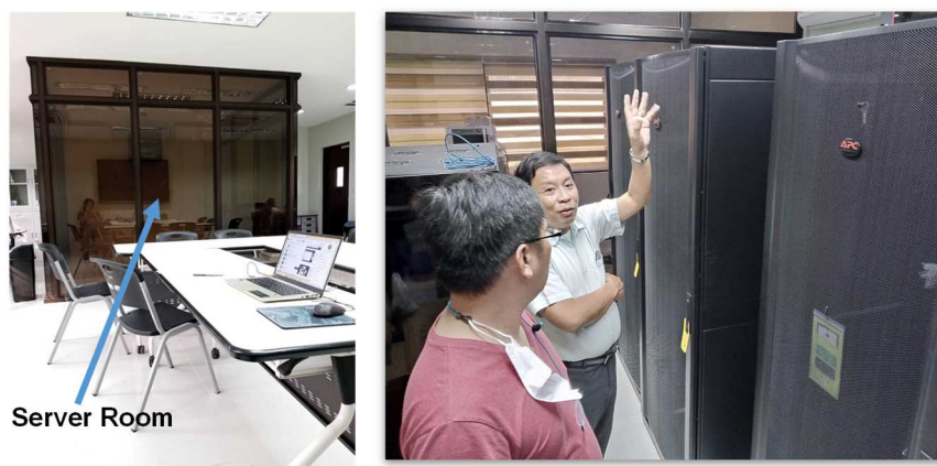
図 10 SATREPS 専用ルーム（左：サーバ室正面より撮影、右：サーバーラック）
