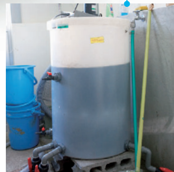
原水を貯めるタンク
