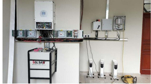
(b) インバーター・バッテリー・負荷の一部及び配線類
