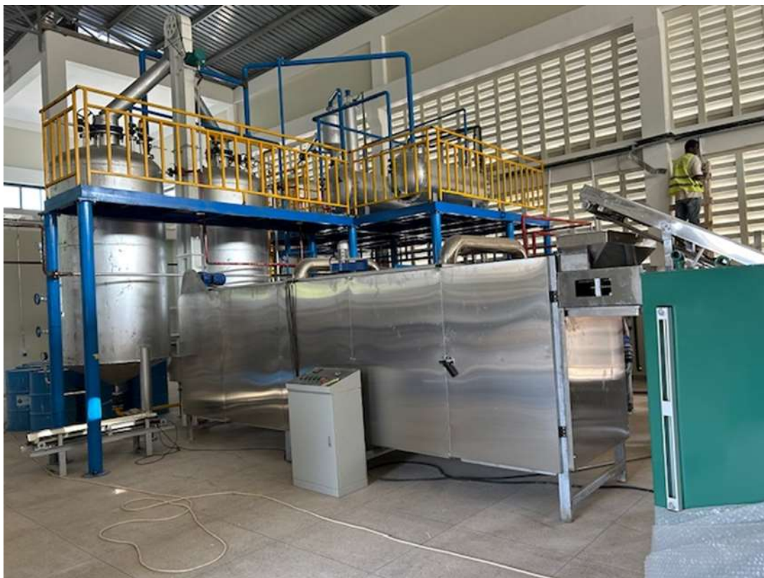
図 3-13 大気圧ヘキサン抽出プラントの前処理部と抽出部
