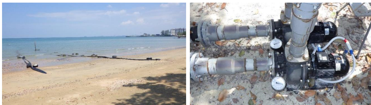
図 3 : 海水取水管および海水取水ポンプ
