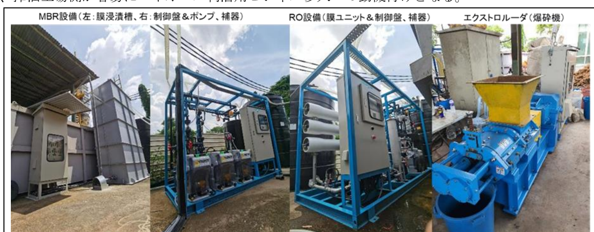
図 12. 新規導入した MBR&RO 設備、爆砕設備(クルアン実証試験地)
