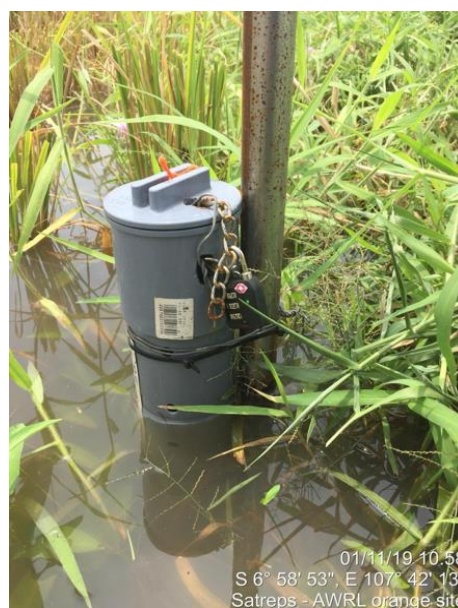
図 1 4 水害テストサイトに設置された水位計の外観
