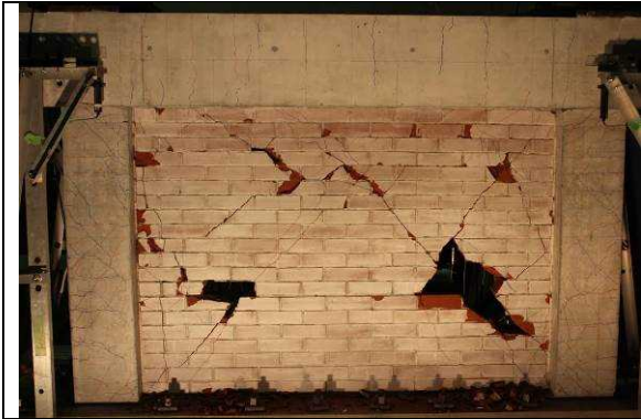
写真7 組積造壁を含むRC造フレームの破壊状況@東北大学 (2016年)
