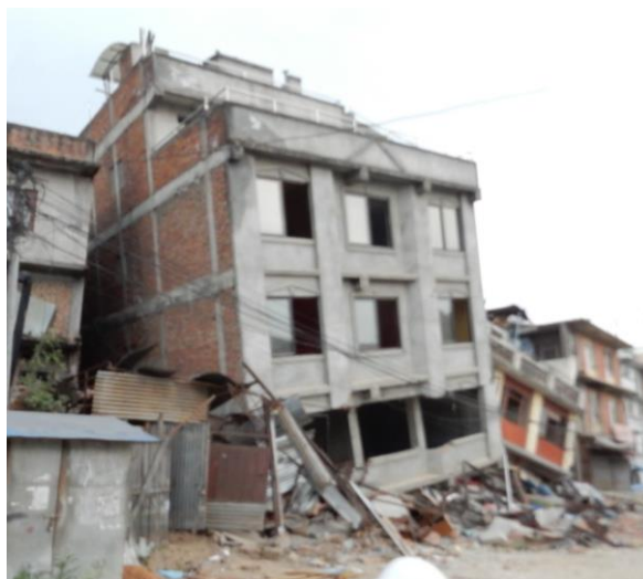
図4. レンガ壁によりピロティ化した建物の崩壊
