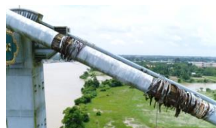
主ケーブル腐食の確認 (ドローン)
