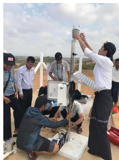
写真 1：自動気象観測用データ収集装置の設置
