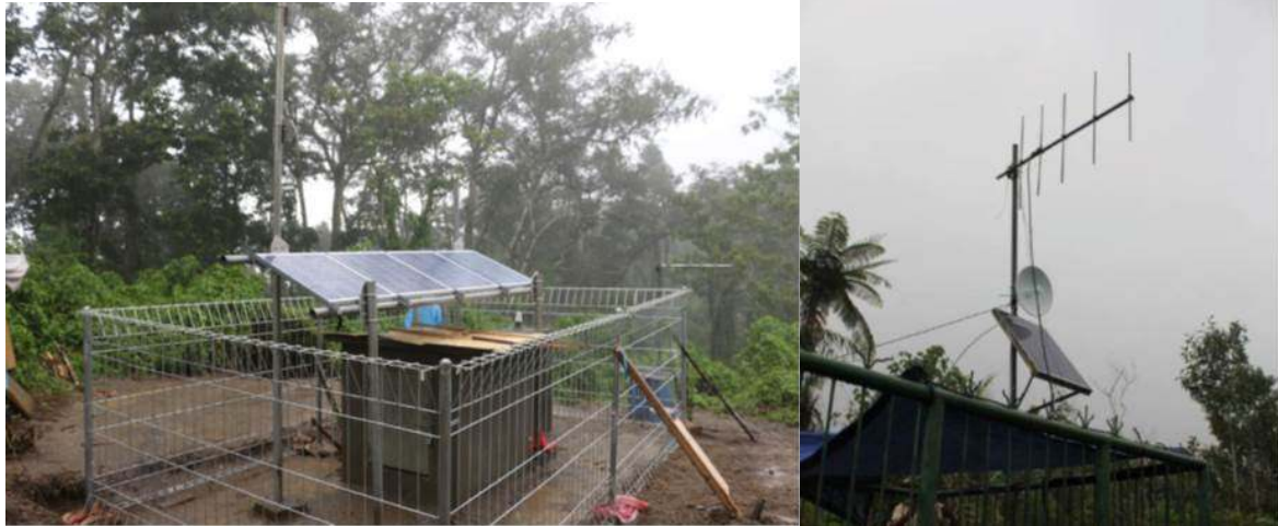
図 1-1 ケルト火山における観測点（左）。スメル火山におけるデジタル伝送観測点（右）。白色のお椀が WiFi アンテナである。
