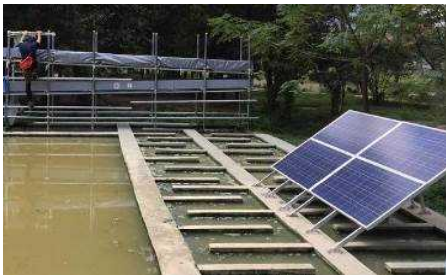
図 4.5 Jwagal 水処理場に設置した大型スポンジ傾斜水処理装置
