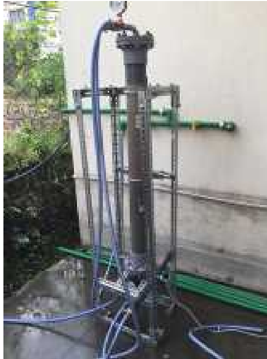
図 4.7 日本側が設置した砂ろ過装置
